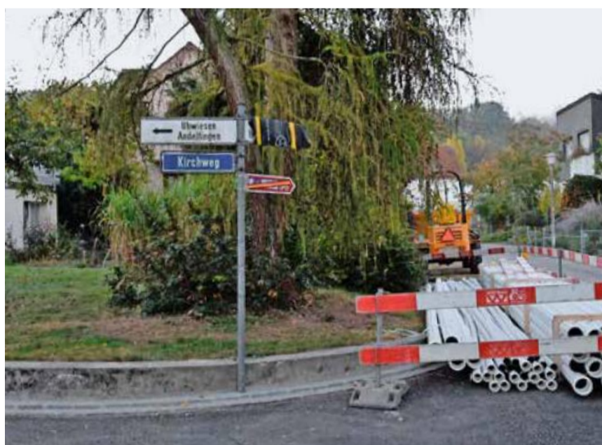
Wegen der Bautätigkeiten an der Lächenstrasse (r.) wurde vermehrt am Kirchweg (l.) und an der Uhwieserstrasse parkiert. Nun wird es hier ein Parkverbot geben. BILD: MBA
